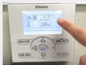
エアコンタイマー設定
